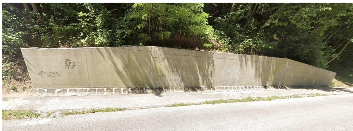
5. b) Oporný múr na ul. Kukučínova na Brezine:
