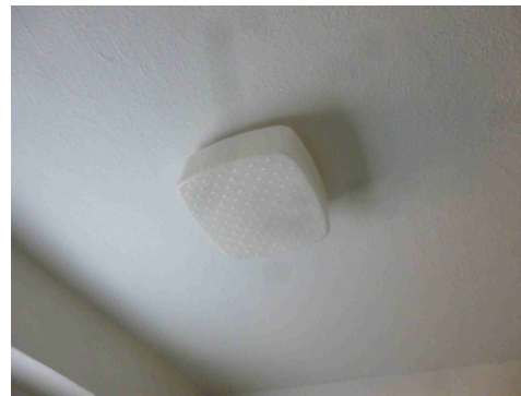
Obr.č.16 Prvky systému umelého osvetlenia
