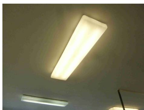
Obr.č.16 Prvky systému umelého osvetlenia
