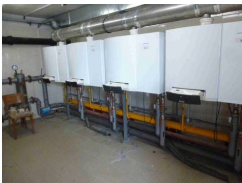
Obr.č.11 Prvky systému vykurovania
