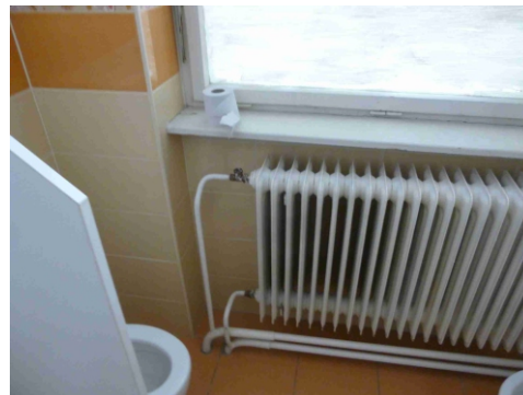
Obr.č.10 Prvky systému vykurovania
