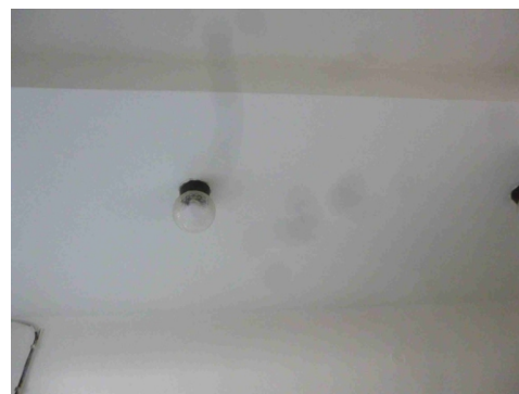
Obr.č.16 Prvky systému umelého osvetlenia
