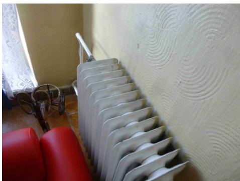
Obr.č.9 Prvky systému vykurovania
