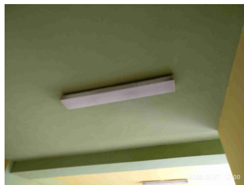
Obr.č.14 Prvky systému umelého osvetlenia
