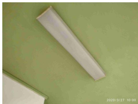
Obr.č.16 Prvky systému umelého osvetlenia
