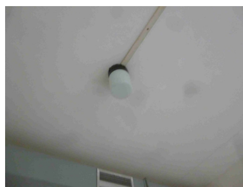
Obr.č.16 Prvky systému umelého osvetlenia
