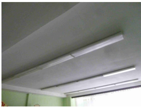
Obr.č.15 Prvky systému umelého osvetlenia
