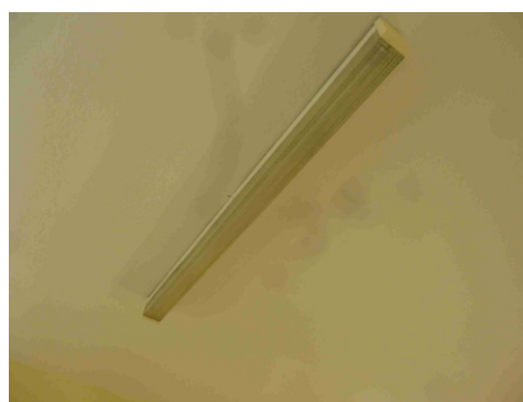
Obr.č.16 Prvky systému umelého osvetlenia
