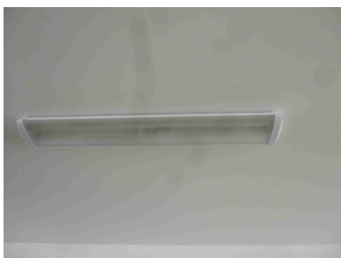
Obr.č.15 Prvky systému umelého osvetlenia
