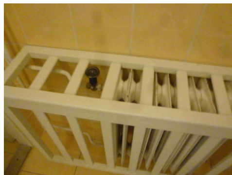
Obr.č.10 Prvky systému vykurovania
