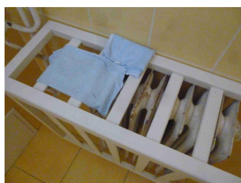
Obr.č.12 Prvky systému vykurovania
