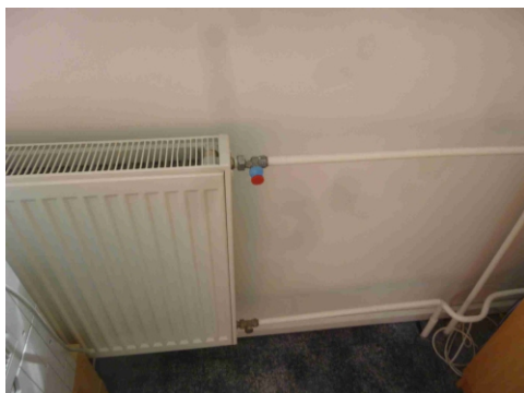
Obr.č.9 Prvky systému vykurovania
