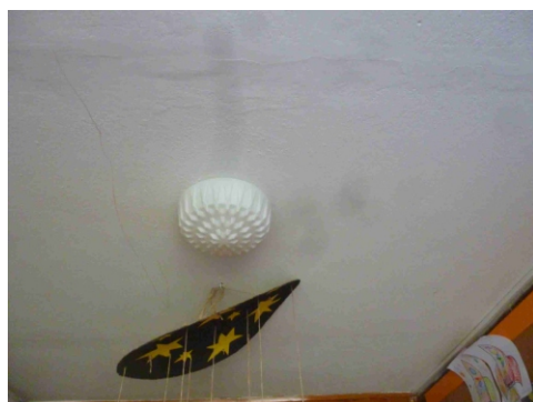
Obr.č.15 Prvky systému umelého osvetlenia
