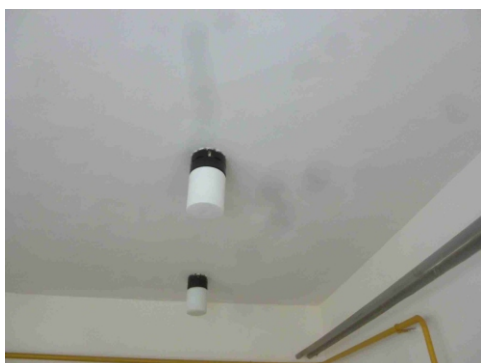
Obr.č.15 Prvky systému umelého osvetlenia
