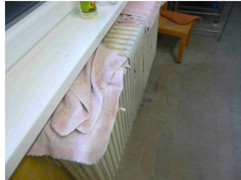
Obr.č.10 Prvky systému vykurovania
