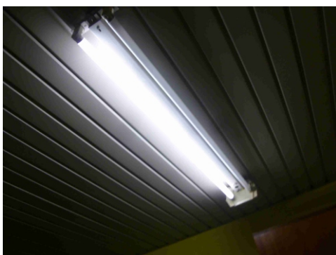
Obr.č.15 Prvky systému umelého osvetlenia
