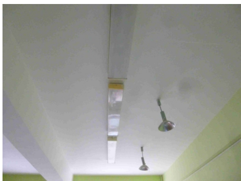
Obr.č.15 Prvky systému umelého osvetlenia
