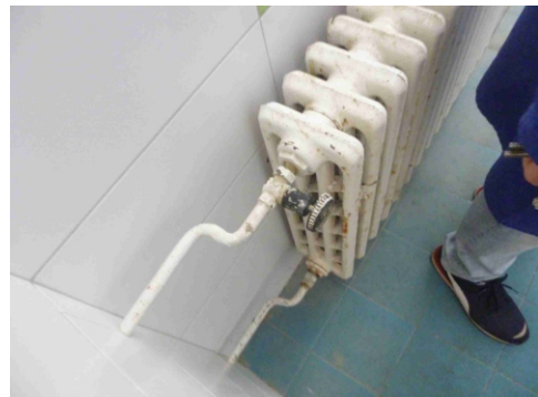
Obr.č.10 Prvky systému vykurovania
