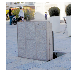
Šachta na dočasné pripojenie elektro
