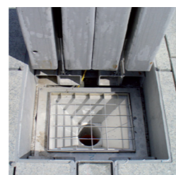
Kanalizačná šachta na dočasné napojenie
