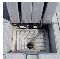
Kanalizačná šachta na dočasné napojenie
