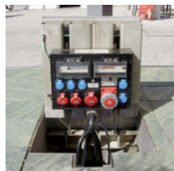
Šachta na dočasné pripojenie elektro
