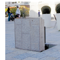
Šachta na dočasné pripojenie elektro
