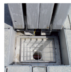
Kanalizačná čachta na dočasné napojenie
