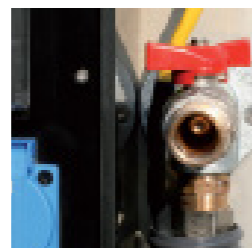
Šachta na dočasné napojenie vody
