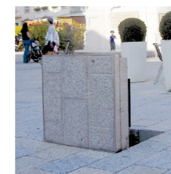
Šachta na dočasné pripojenie elektro
