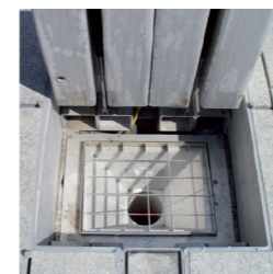
Kanalizačná čachta na dočasné napojenie
