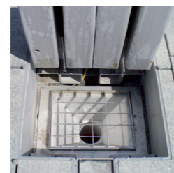
Kanalizačná čachta na dočasné napojenie
