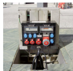
achta na doasne pripojenie elektro
