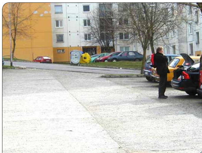
> Viaceré parkoviská na Juhu nemajú asfaltový povrch
